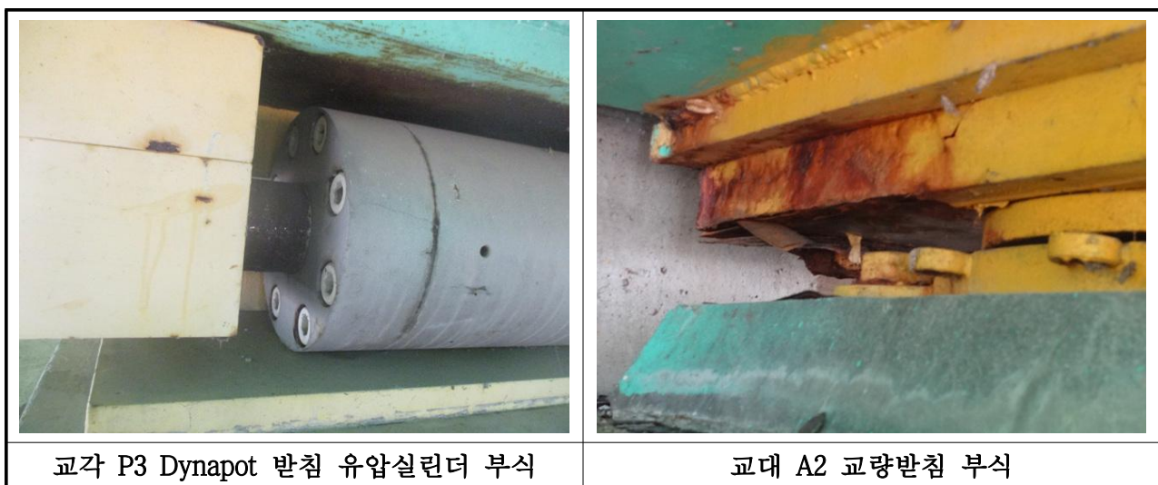
【사진 3.15】 교량받침 손상현황
