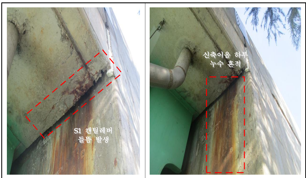
【사진 3.4】 캔틸레버 들뜸 현황
