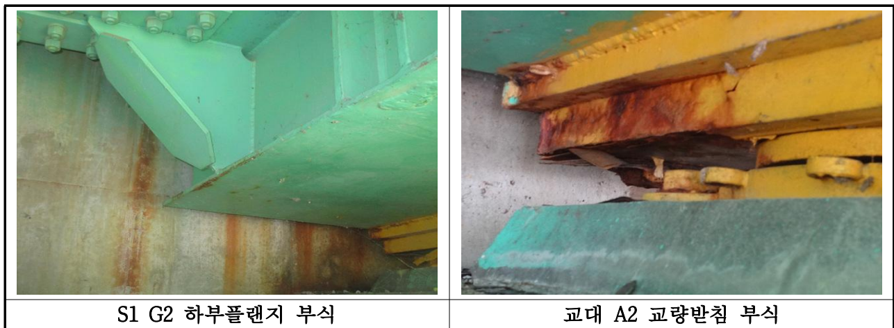
【사진 7.1】 신축이음 누수에 따른 손상 발생 현황
